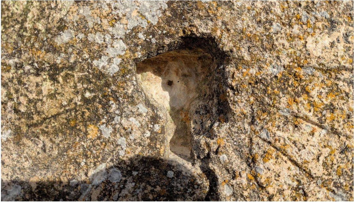
Figura 6. Detalle de la oquedad tras la limpieza en el que se aprecia un fragmento de hierro que se podría corresponder con la varilla original.
