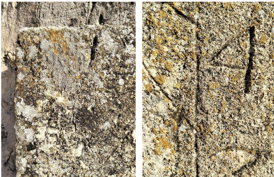
Figuras 3 y Detalle del biodeterioro y la suciedad incrustada previos a la intervención.
